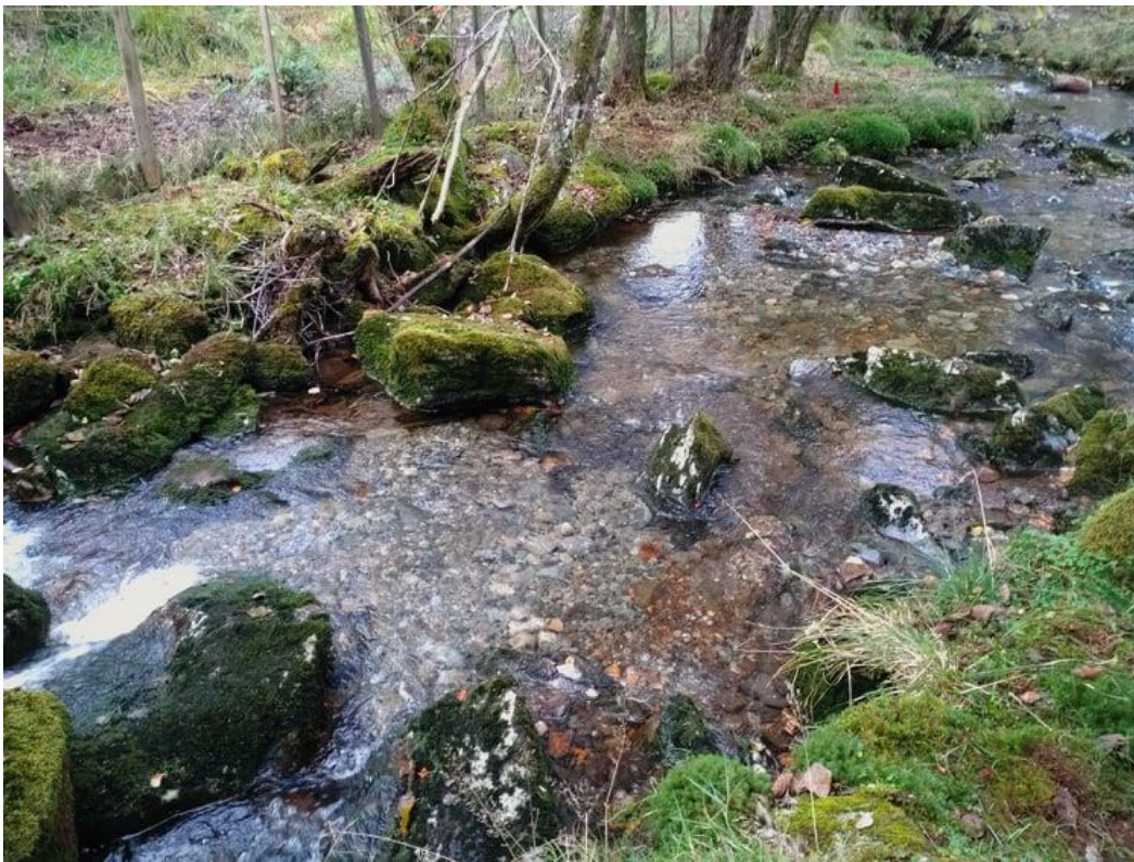
I to kulper ble det lagt ut gytegrus som fordeler seg nedover bekken. Utlegget ble gjort ved bruk av gravemaskin.
